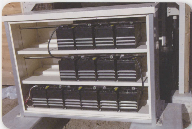
大容量鉛蓄電池
