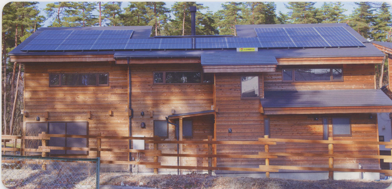
3号棟太陽光発電パネル
